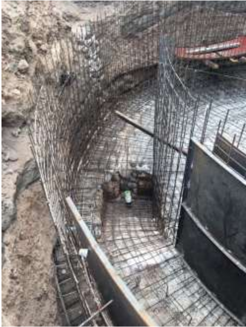
Neuer 2-Kammern-Wassertank für Frisch- und Brauchwasser
